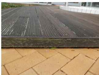
Stufe im Außenbereich der Therme
