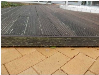
Stufe im Außenbereich der Therme
