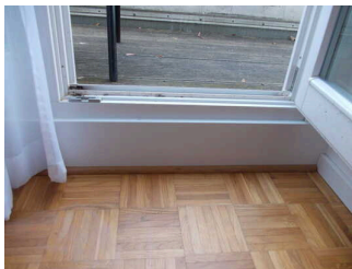
Stufe an der Balkontür
