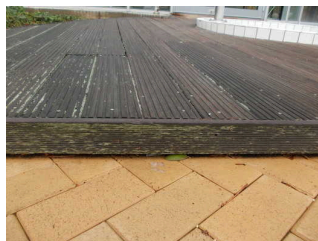
Stufe im Außenbereich der Therme
