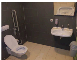
Waschbecken und WC im Saunabereich
